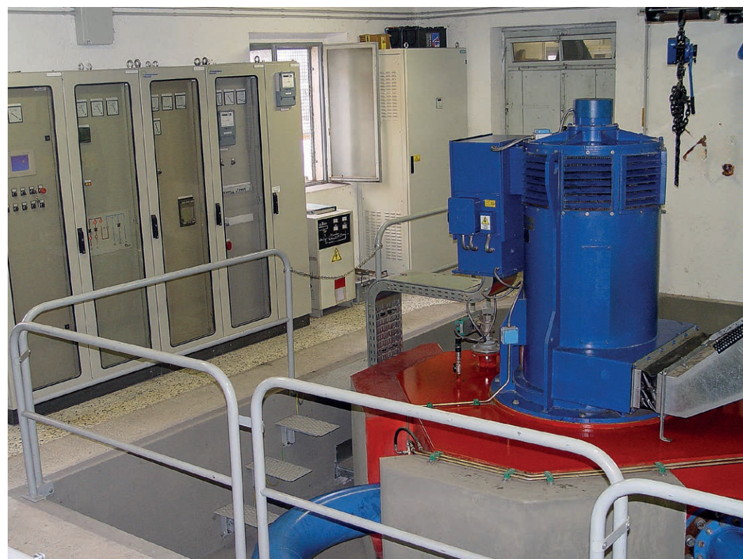
Nuovo gruppo turbina/alternatore centrale "Dria" post rifacimento del 2002
