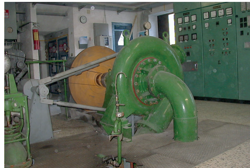
Gruppo turbina/alternatore centrale "Dria" prima del rifacimento del 2002
