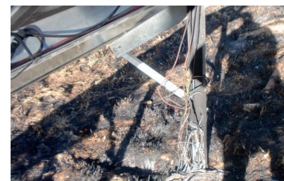
Incendio parco FV "Plan dal Moru"
