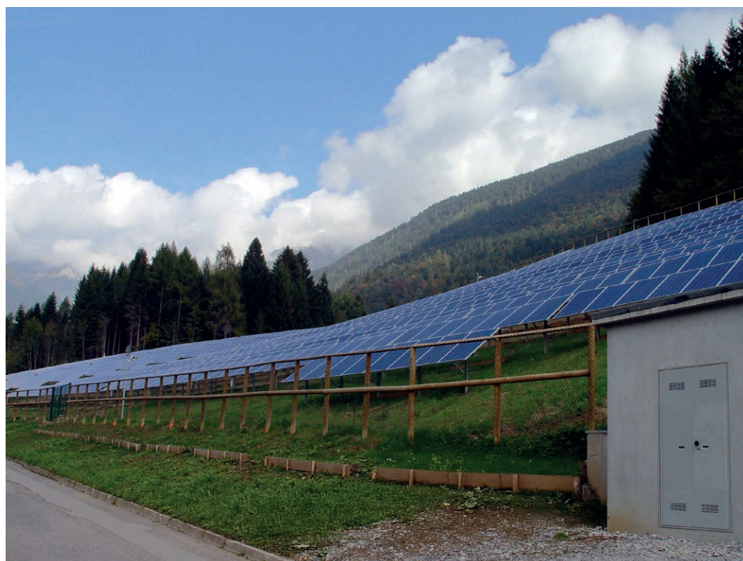
Parco fotovoltaico "Plan dal Moru"
