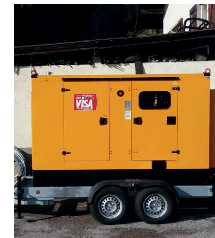
Nuovo generatore 240 kVA
