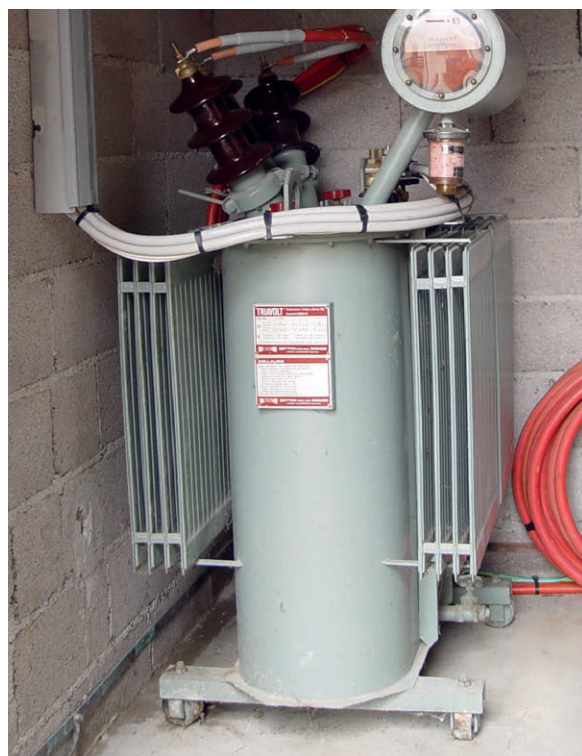
Trasformatore cabina "Augusto"
